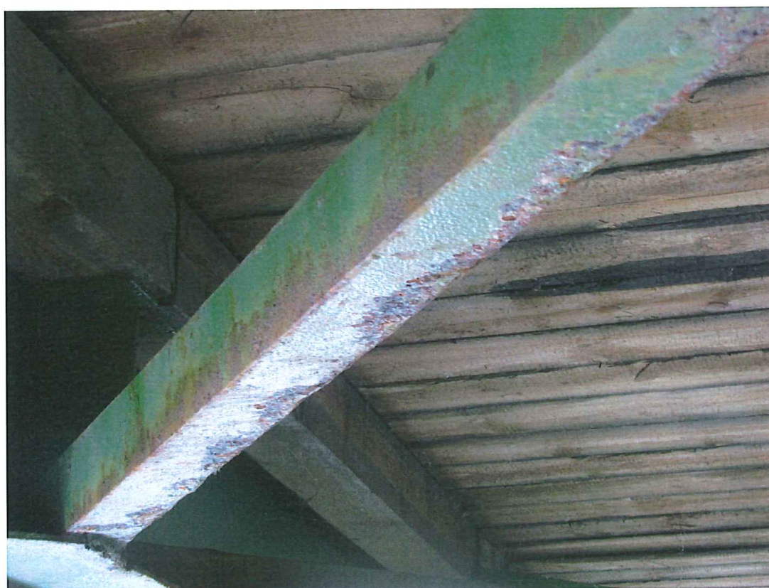
Fot. 9 – Korozja wiatrownicy w stadium zaawansowanym
