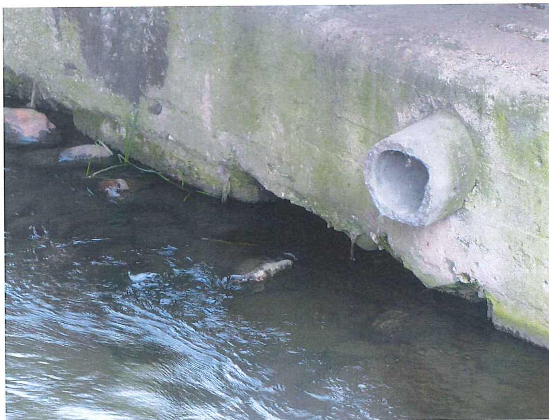
Fot. 13 – Ubytki korozyjne betonu korpusu przyczółka prawobrzeżnego w poziomie lustra wody
