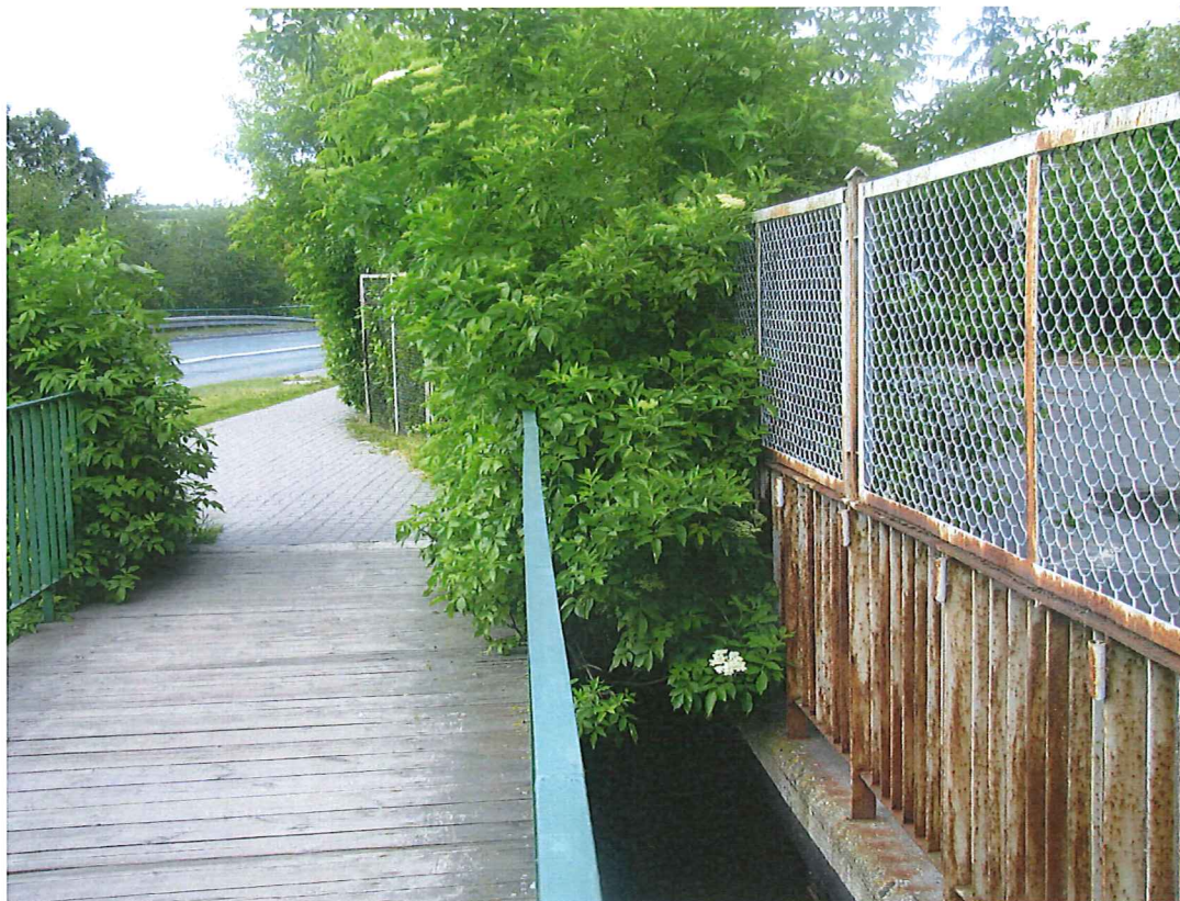
Fot. 16 – Intensywny porost roślinności na skarpie w bezpośrednim sąsiedztwie obiektu
