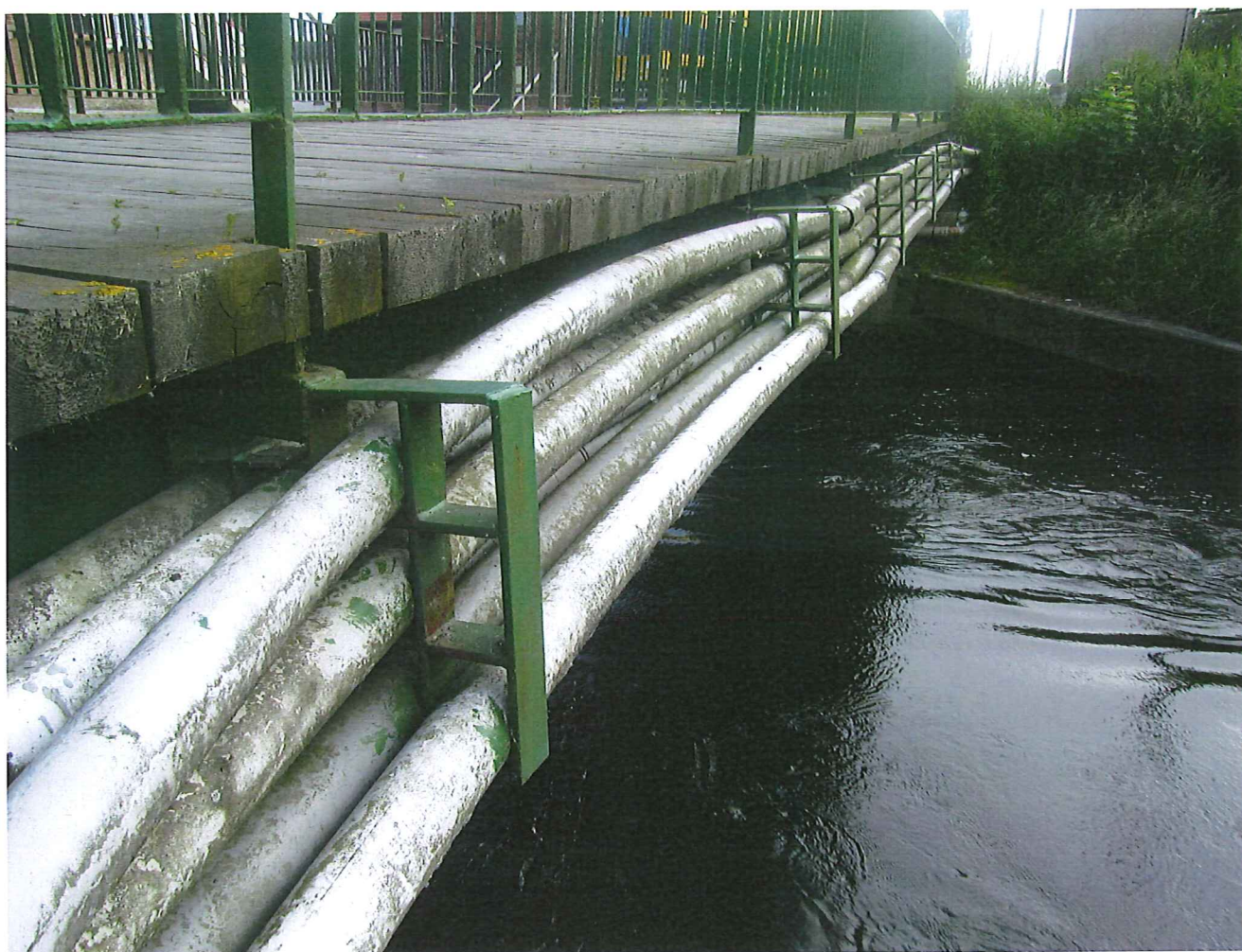
Fot. 14 – Nieestetyczne zamocowanie (zwis) rur osłonowych przewodów urządzeń obcych
