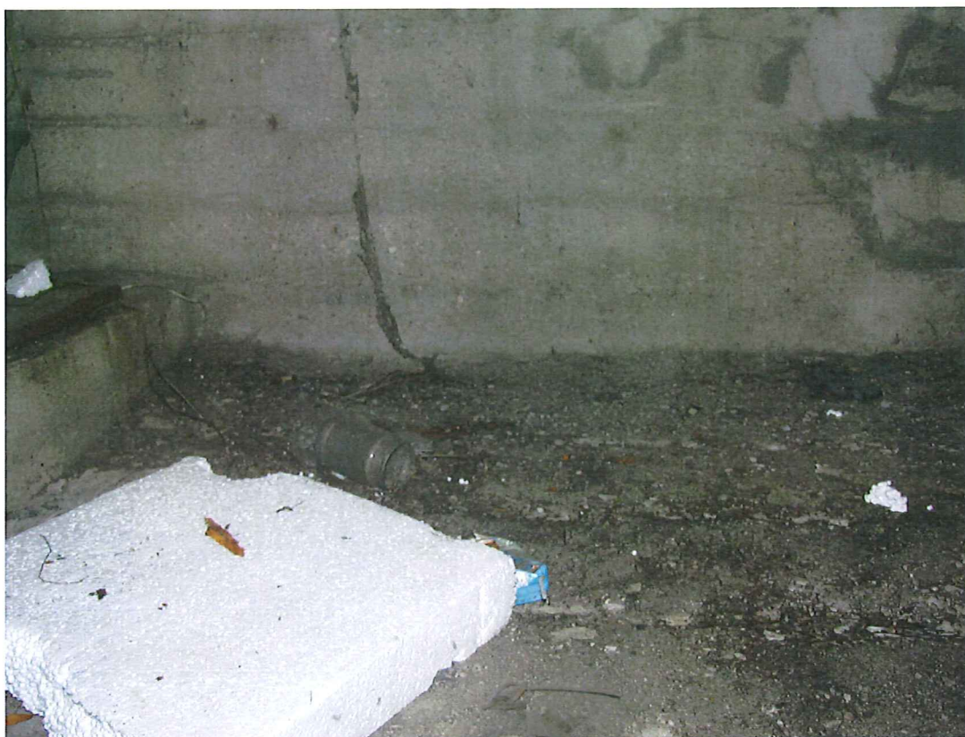
Fot. 14 – Zanieczyszczenia ławy łóżyskowej
