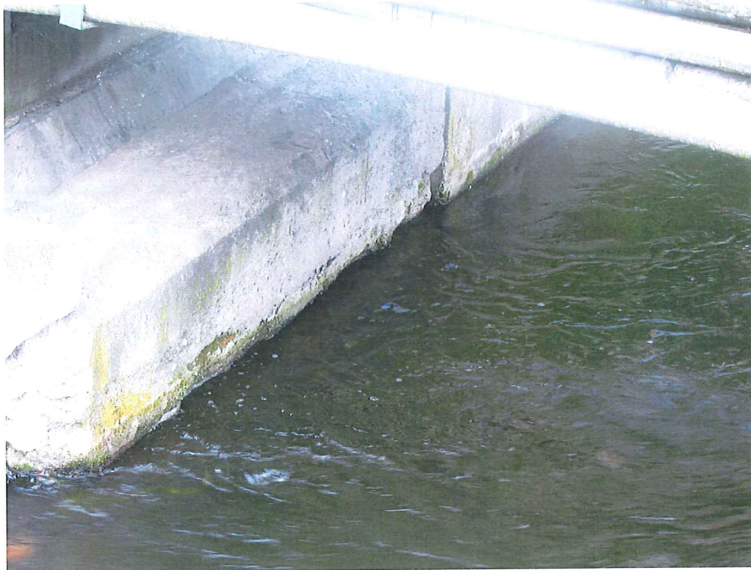
Fot. 12 – Ubytki korozyjne betonu korpusu przyczółka lewobrzeżnego w poziomie lustra wody
