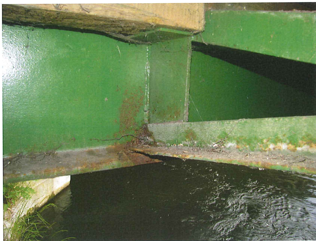
Fot. 9 – Korozja dolnej półki dźwigara i wiatrownicy w stadium zaawansowanym
