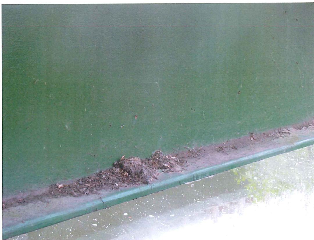
Fot. 8 – Zanieczyszczenie na dolnej półce dźwigara
