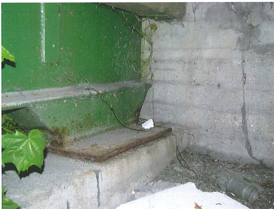
Fot. 11 – Intensywna korozja stalowego elementu podparcia dźwigara
