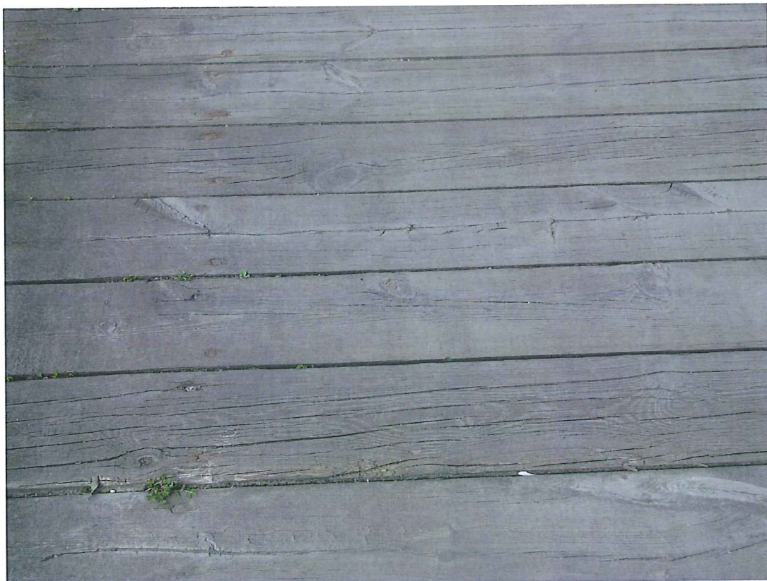
Fot. 7 – Spękania dyliny pomostu
