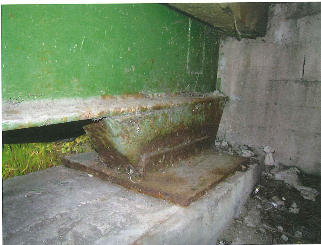
Fot. 10 – Intensywna korozja stalowego elementu podparcia dźwigara
