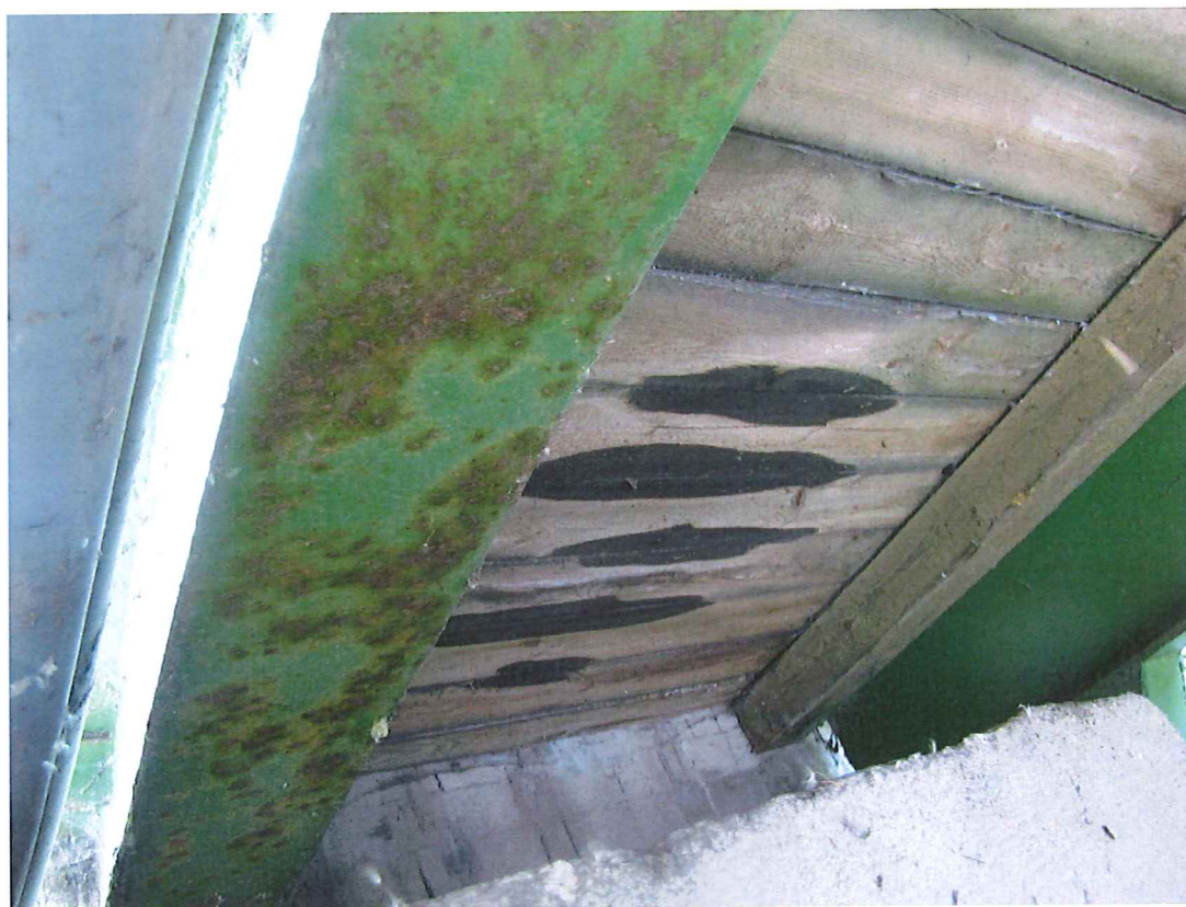
Fot. 8 – Korozja dolnej półki dźwigara w stadium średniozaawansowanym
