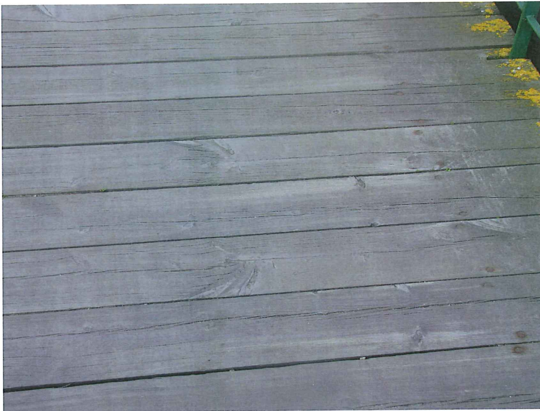
Fot. 6 – Spękania dyliny pomostu
