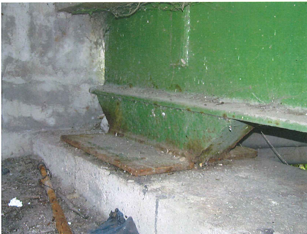
Fot. 10 – Intensywna korozja stalowego elementu podparcia dźwigara
