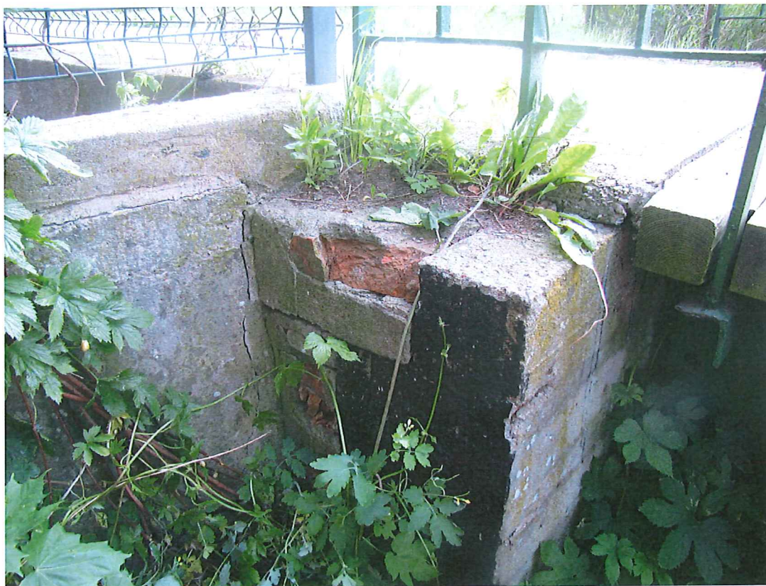
Fot. 12 – Ubytki korozyjne cegieł ścianki za przyczółkiem
