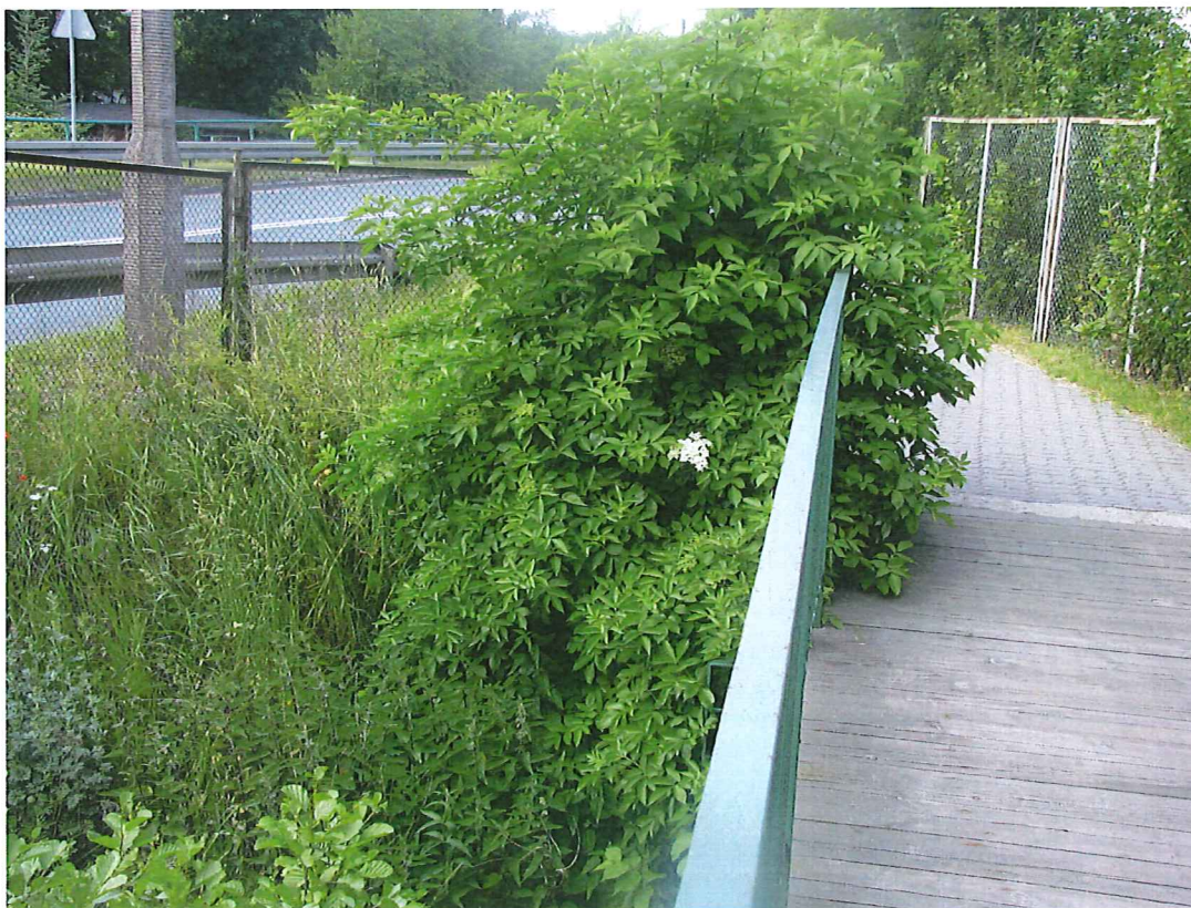
Fot. 17 – Intensywny porost roślinności na skarpie w bezpośrednim sąsiedztwie obiektu
