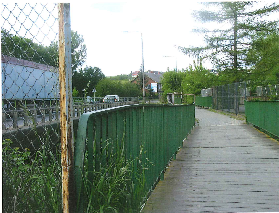
Fot. 3. – Linia balustrady po prawej stronie ciągu pieszego
