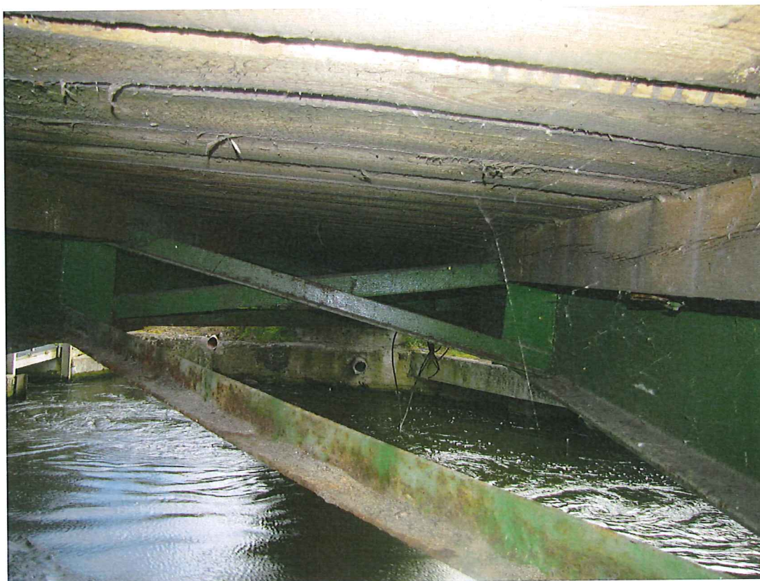
Fot. 11 – Korozja dolnej półki wiatrownicy w stadium zaawansowanym
